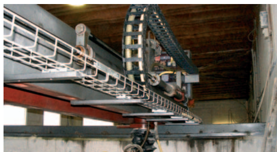
▲ Chez Spadaccini, Yves Kohler gère l'entretien des ponts et de la débiteuse Bisso pour laquelle il vient de modifier tout le chemin de câble.
