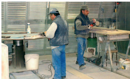
▲ Fabrication maison et installation, des tables de travail hydrauliques pour les tailleurs de pierre de la marbrerie DBPM.
